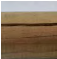
Cracks/Grietas/Fente/Risse/ Crepe/ Barsten/Fendas
